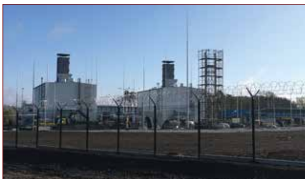
obr. 1 Kompresorová stanica KS05 Lakšárska Nová Ves Zdroj: Eustream
