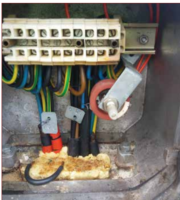
obr. 1 Omezovací odpor anody v RU Rozvadov
