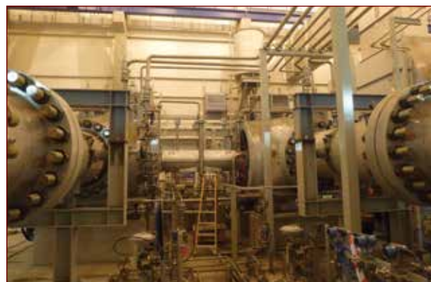
obr. 5 Tandemové usporiadanie kompresorov na KS03 Zdroj: Eustream
